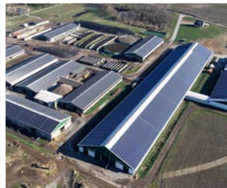
Dach-PV Anlagen mit Batteriespeicher
