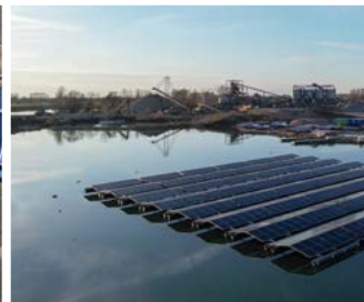
Floating-PV-Anlagen auf Gewässern
